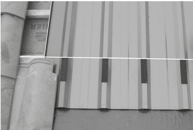
Fig. 20 A l'aide d'un cordeau, placez la première rangée de joints autocollants à l'aplomb de la planche A : un joint sur chaque onde.
